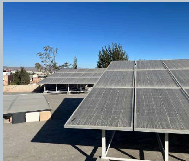
Paneles Solares del Pabellón Principal
